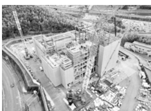
▲エネルギー回収型 廃棄物処理施設
