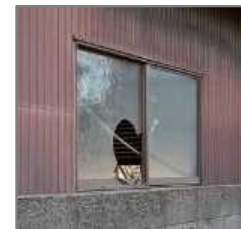
窓が割れた管理不全空家
