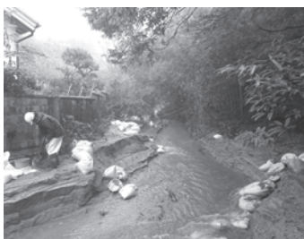
台風による被害の様子
